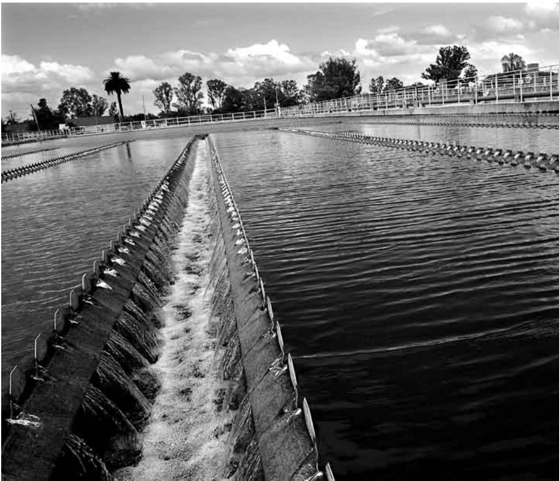
Planta potabilizadora de OSE, en Aguas Corrientes. * FOTO: PABLO NOGUEIRA (ARCHIVO, FEBRERO DE 2008)
